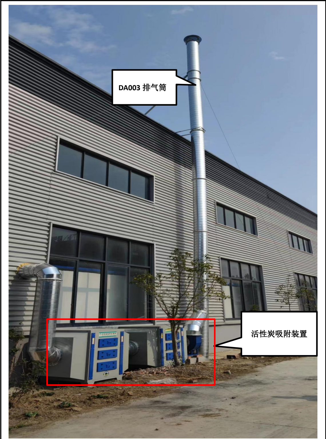
图 3-5 危废暂存间环保措施以及 DA003 排气筒图
