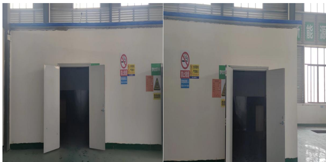
图3-2 项目未破损以及破损电池暂存间（密闭车间）图
