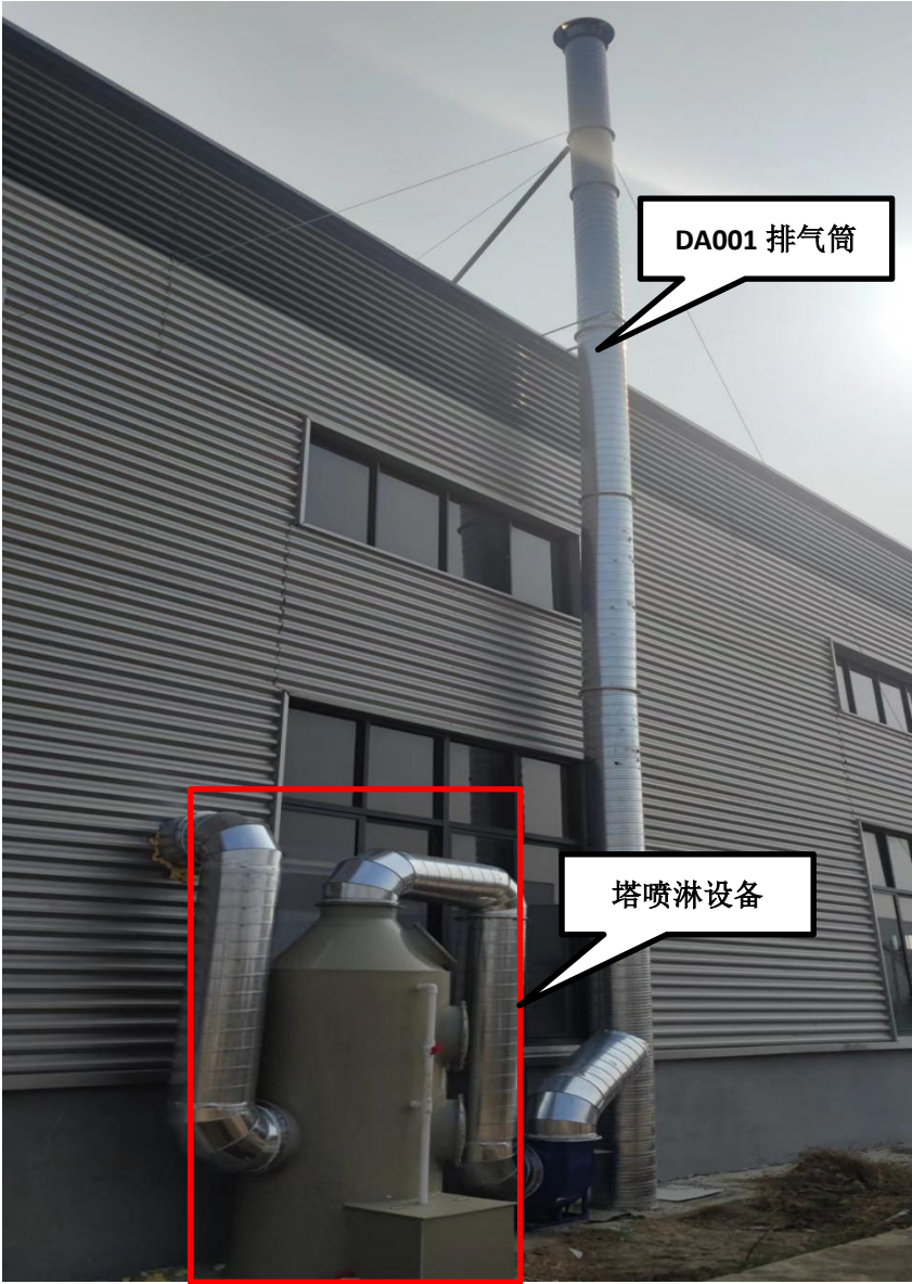
图 3-3 项目塔喷淋设备以及 DA001 排气筒图
