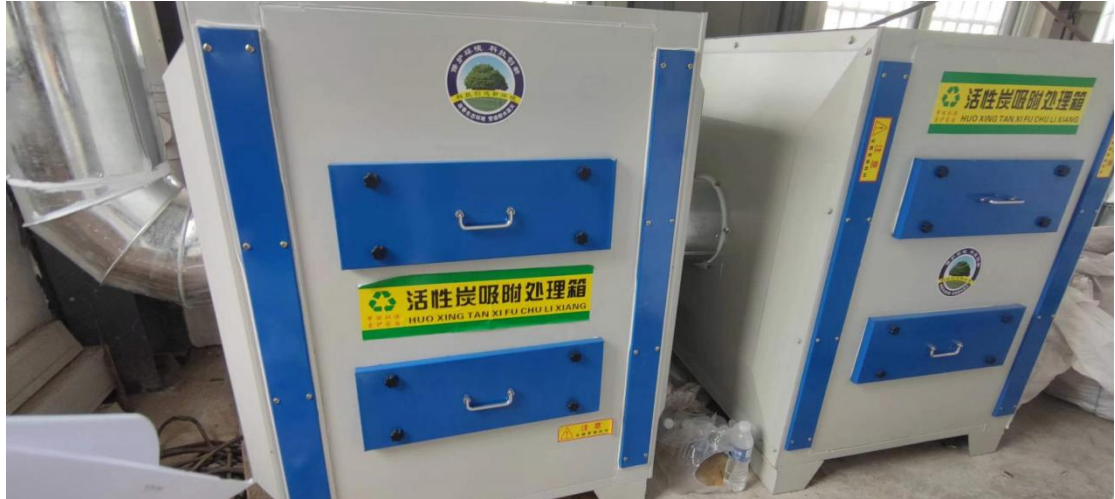
图3-3 项目活性炭吸附装置
